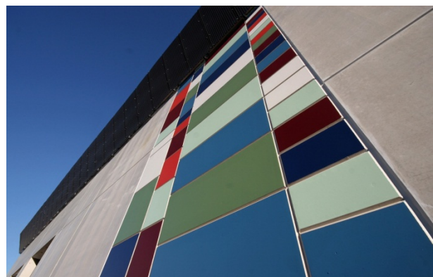
Farbliche Akzente schmücken die Außenwände. Das Raster aus Scheinfugen wurde bereits in der Produktion angelegt.
