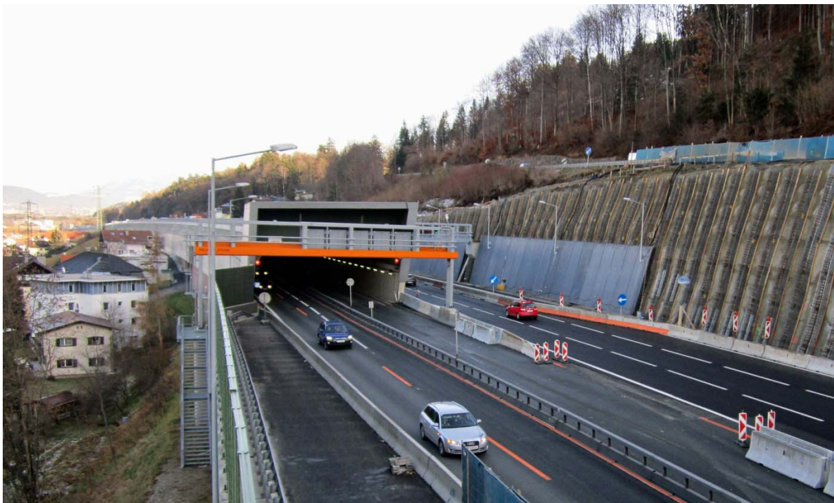
Baustellenüberblick: Wohnhäuser stehen direkt an der hochbelasteten A12. Daher wurde die Autobahn zum Lärmschutz eingehaust. In Bildmitte der Tunnelmund der Nordröhre. Vom Hang rechts wurden rund 2,5 m abgetragen, um Platz zuschaffen für einen Pannenstreifen. Die neue Hangsicherung besteht aus rückverankerten Doppelwandelementen. Foto: Kneringer
