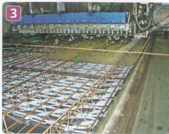
Einbringen des Werkbetons. Ab diesem Zeitpunkt sind alle Deckeneinbauten für den späteren Baustelleneinsatz geschützt
