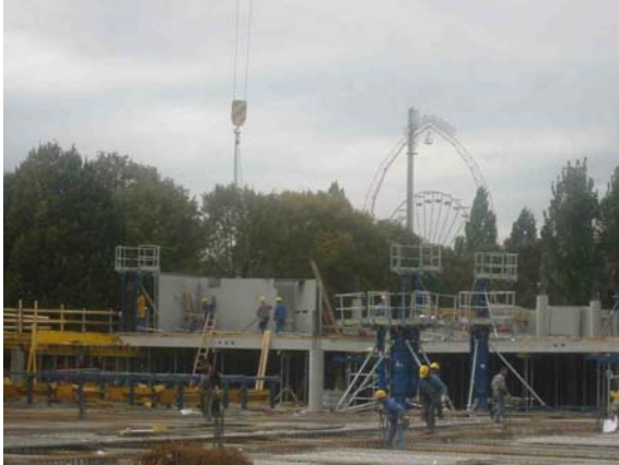
Das neue Messe- und Kongresszentrum Wien – hier die Baustelle des Parkhauses West – liegt in Sichtweite des bekannten Volkspraters in den Donauauen.
