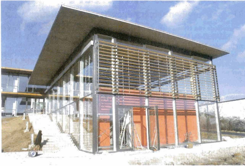
Ausstellungshalle in Massing. Das 15 mal 20 Meter große Dach wurde aus sieben Vollfertigteilen zusammengesetzt.
