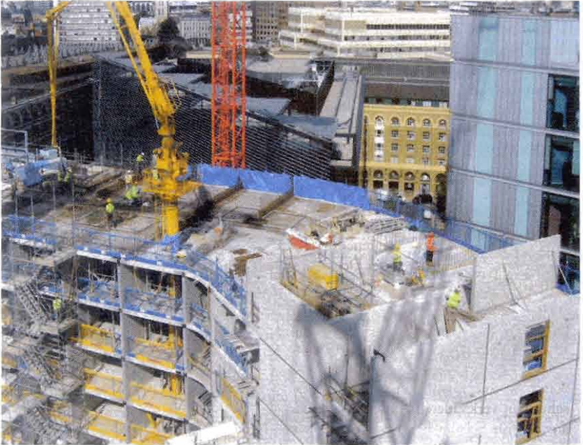
Für den Rohbau lieferte ein deutsches Fertigteilwerk Deckenelemente, Doppelwandelemente und Fertigtreppe. Fertiggäbäder aus britischer Produktion trugen zur weiteren Beschleunigung des Bauablaufs bei. Fotos: Syspro/Betoform
