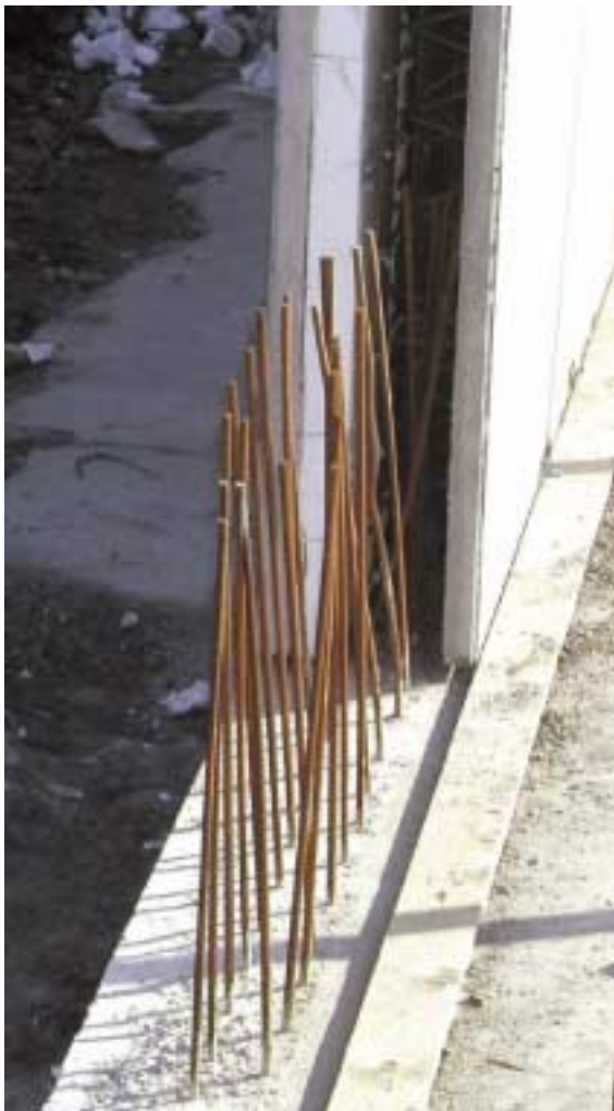
Bilder 8 und 9. Mangelhafte Ausführung der Anschlüsse Figs. 8 and 9. Inadequate construction of connections
