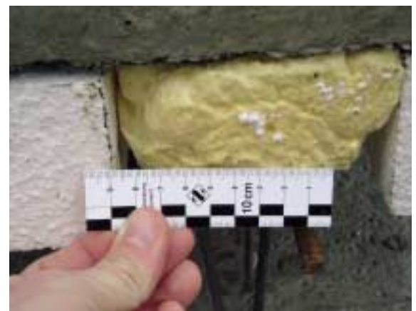
Bild 3. Unautorisierter Nachbau von Thermowänden mit räumlichen Gitterträgern aus normalem Baustahl Fig. 3. Unauthorized copy of thermowall with spatial lattice beams made of standard structural steel
