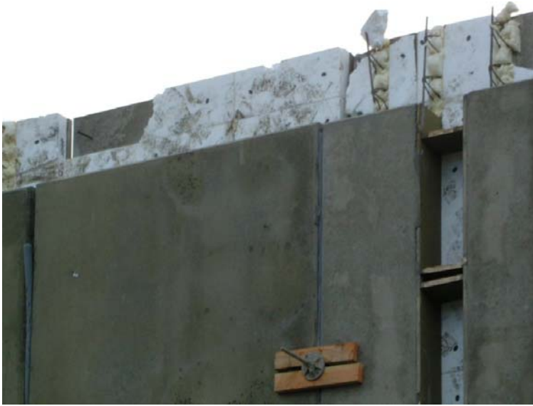
BILD 4: Keine Rede von einer dämmtechnisch einwandfreien Aussenwand.
