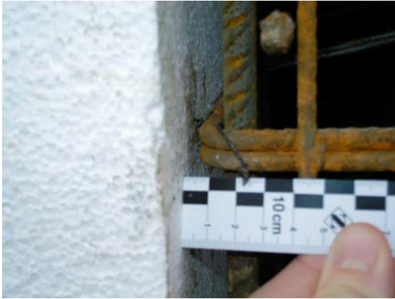
BILD 9: Die regelwidrig verlegte Bewehrung bewirkt, dass die Betondeckung stellenweise gegen null tendiert.
