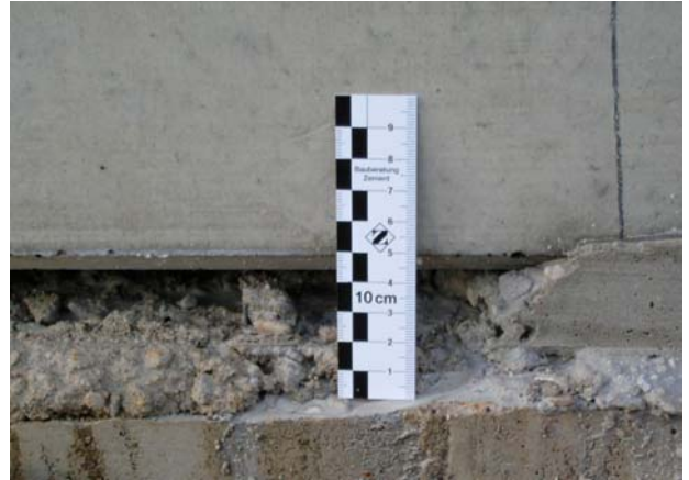
BILD 10: Ausgerechnet am statisch sensiblen Fusspunkt der Außenwand lässt die Betonqualität zu wünschen übrig.
